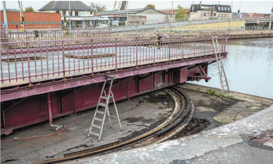
De 104 jaar oude Krakelebrug werd aangevaren en is defect. (foto Davy Coghe)
